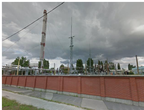
120 kV-os kapcsolóberendezések, Berliini utca
