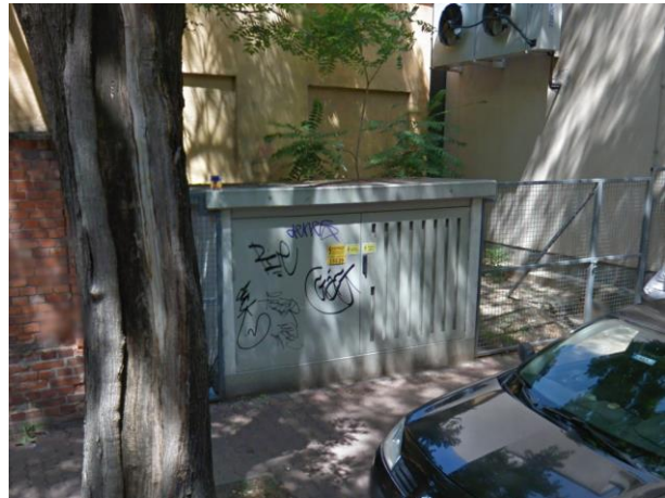
5139 sz. betonházas 10/0,4 kv-os transzformátor, József Attila utca
