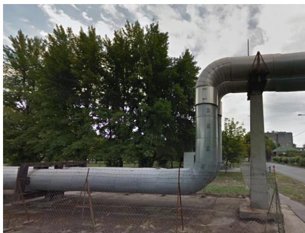
Fv 2 DN 600 magasvezetésű távhővezeték az Elem utcában
