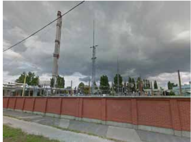
120 kV-os kapcsolóberendezések, Berliini utca
