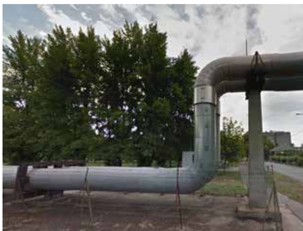
Fv 2 DN 600 magasvezetésű távhővezeték az Elem utcában
