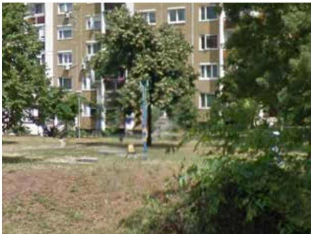
Földbe süllyesztett körzeti gáznyomásszabályzó a Pozsonyi utca mellett
