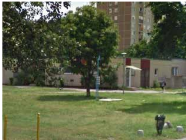
Földbe süllyesztett körzeti gáznyomásszabályzó a Viola utcánál
