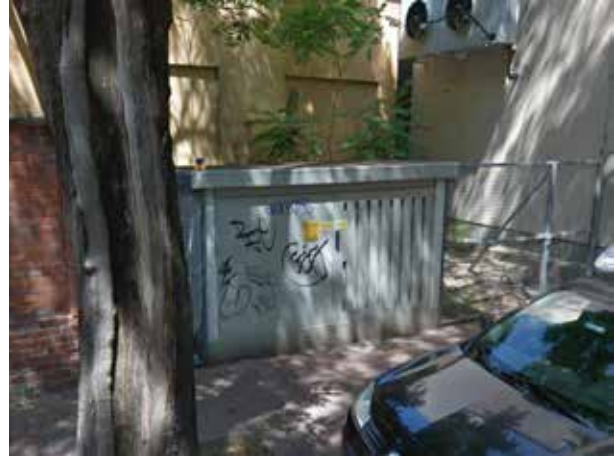
5139 sz. betonházas 10/0,4 kV-os transzformátor, József Attila utca
